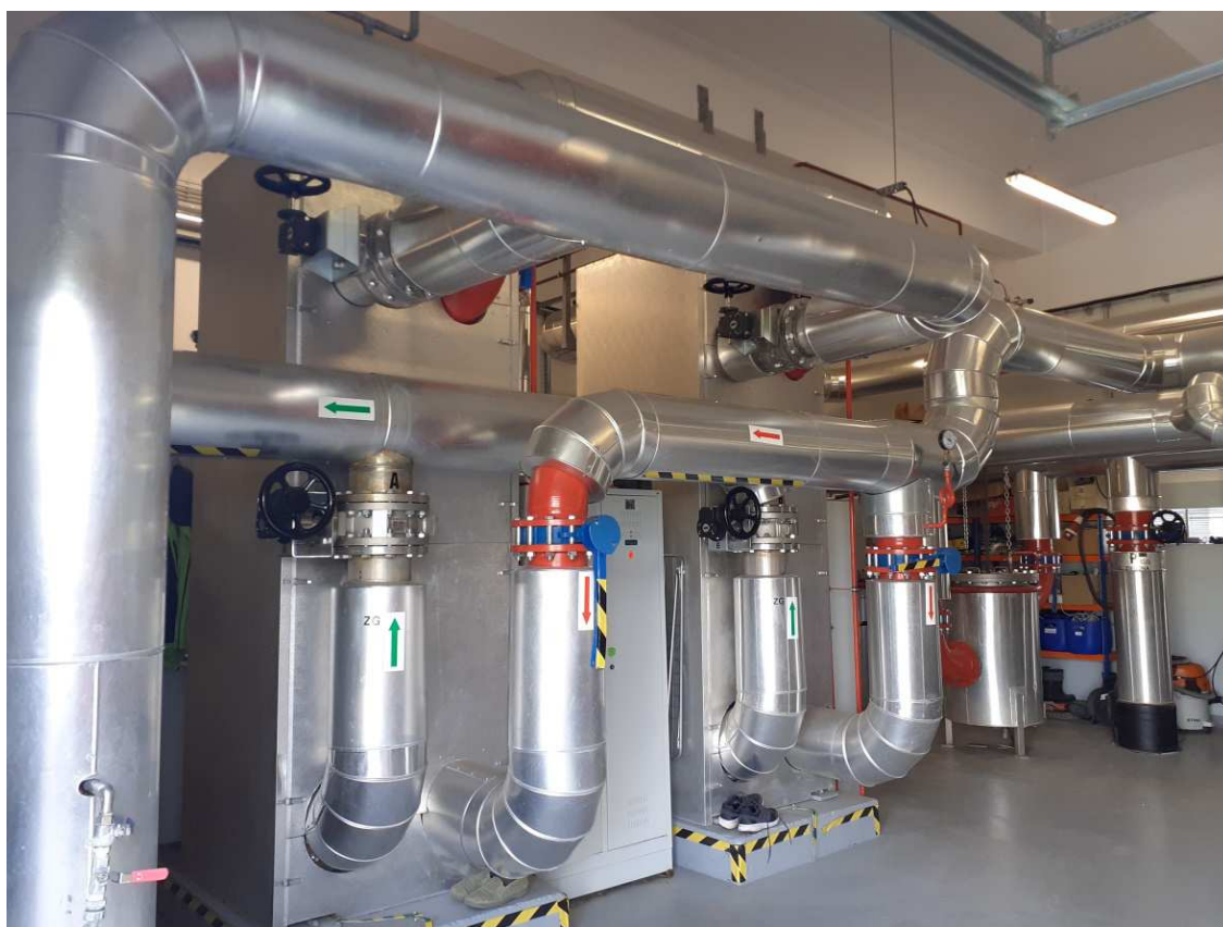
Fot. 5.3. Wymiennikownia ciepła w ciepłowni geotermalnej Poddebice ( fot. Archiwum Geotermii Poddebice Sp. z o.o. )
