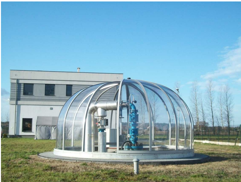
Fot. 3.1.1. Głowica otworu geotermalnego Poddębice GT-2 ( fot. Archiwum Geotermii Poddębice Sp. z o.o. )
