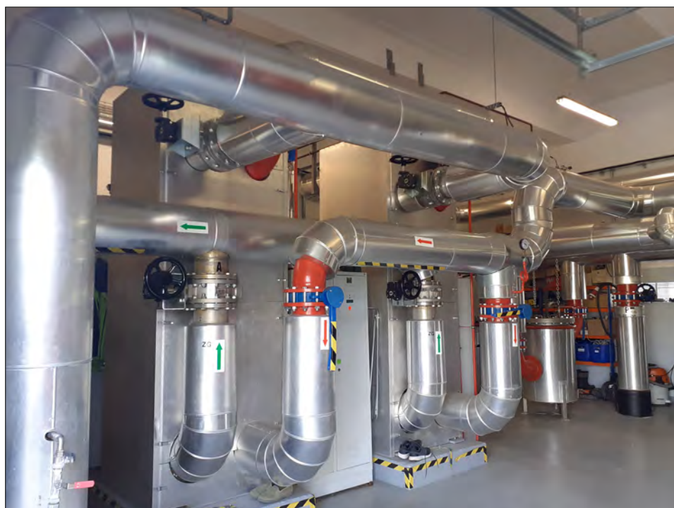
Fot. 5.3. Wymiennikownia ciepła z urządzeniami technologicznymi (fot. Archiwum Geotermii Poddębice Sp. z o.o.)
