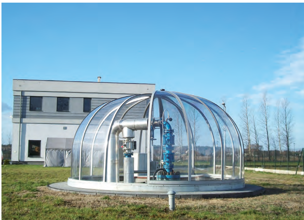
Fot. 3.1. Głowica otworu geotermalnego Poddębice GT-2 zabudowanego kopułą ( fot. Archiwum Geotermii Poddębice Sp. z o.o. )
